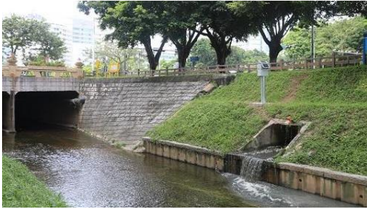
重点避开 3: 河道中有管道出水口处
